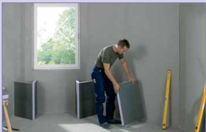
Als Unterkonstruktion für den Waschtisch werden die Bauplatten-Elemente an Wand und Boden angeklebt.
