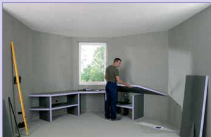
Die Waschtischplatte wird auf die Unterkonstruktion aufgeklebt. Vor dem Verfliesen werden alle Plattenstöße und sichtbaren Stirnkanten mit JACKOBOARD Armierband armiert.
