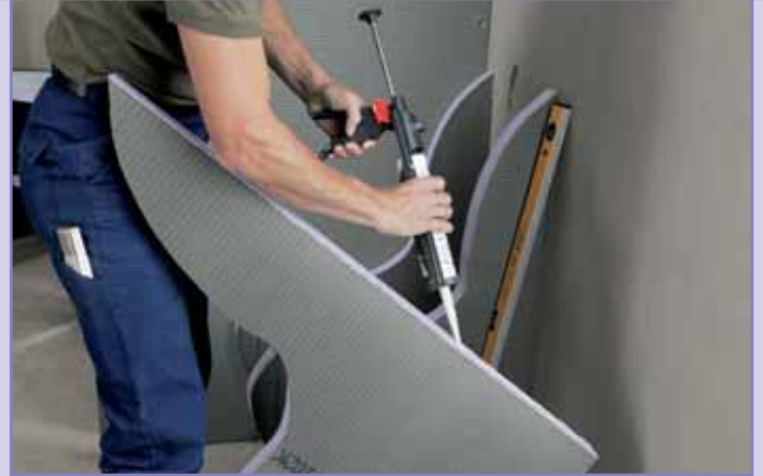
Die JACKOBOARD Bauplattenelemente werden im Abstand von ca. 40 cm mit JACKODUR Montagekleber an Wand und Boden angeklebt.
